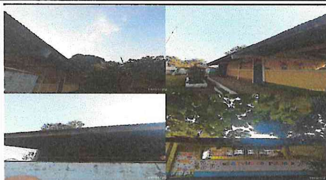
Foto 1: Techo en mal estado
