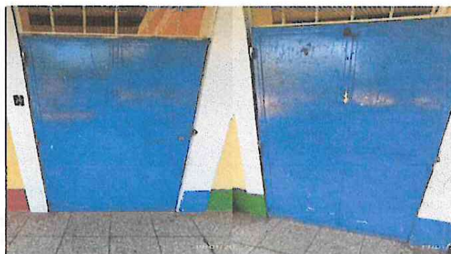
Foto 4: puertas sin chapa y oxidadas
