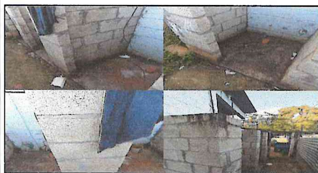
Foto 5: Baños sin tazas ni techo
