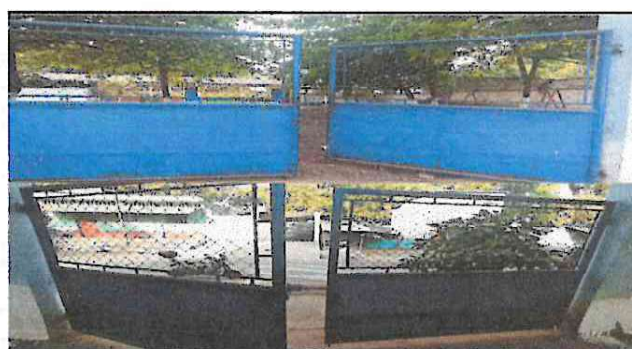
Foto 6: Portone en estado de oxidación
