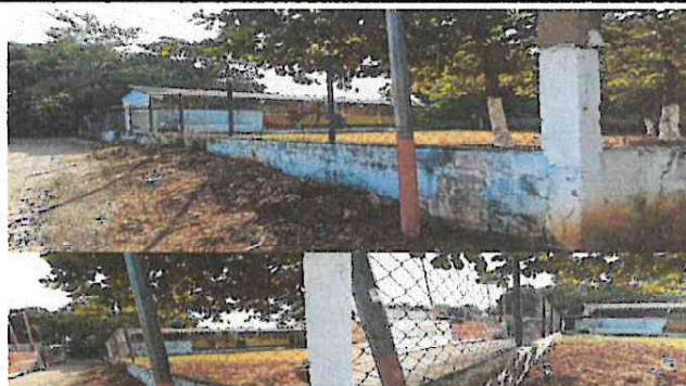
Foto 2: Muro perimetral al borde del colapso
